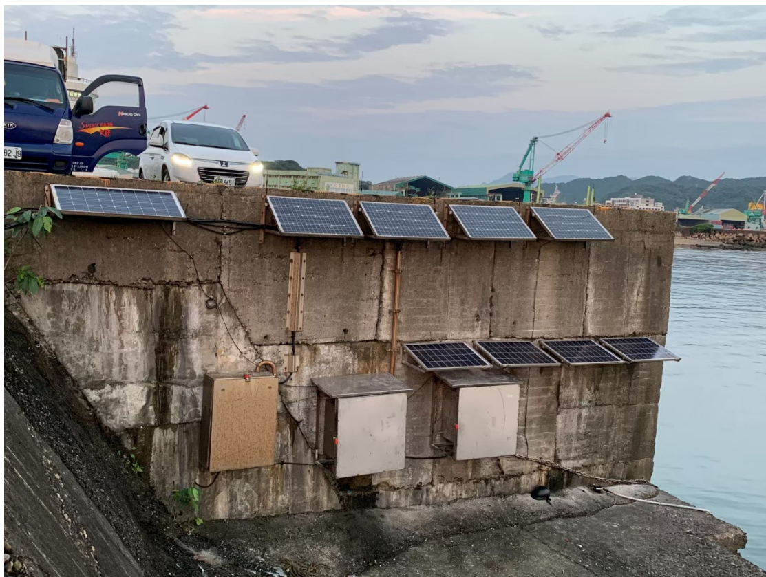
圖 3.2 基隆港海流測站岸上設備照片
