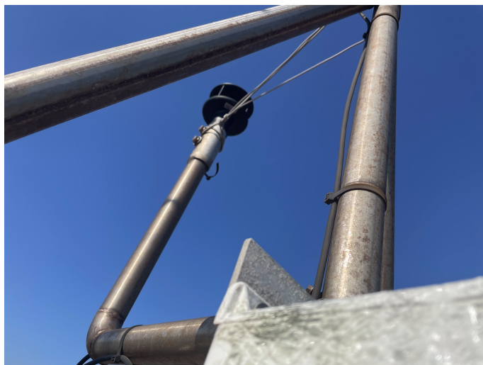
圖 11.2 馬祖南竿福澳港風力觀測站現地照片
